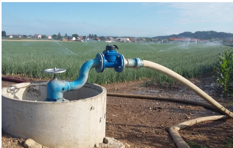
Slika 5.1: Namakalne naprave in sistemi.
